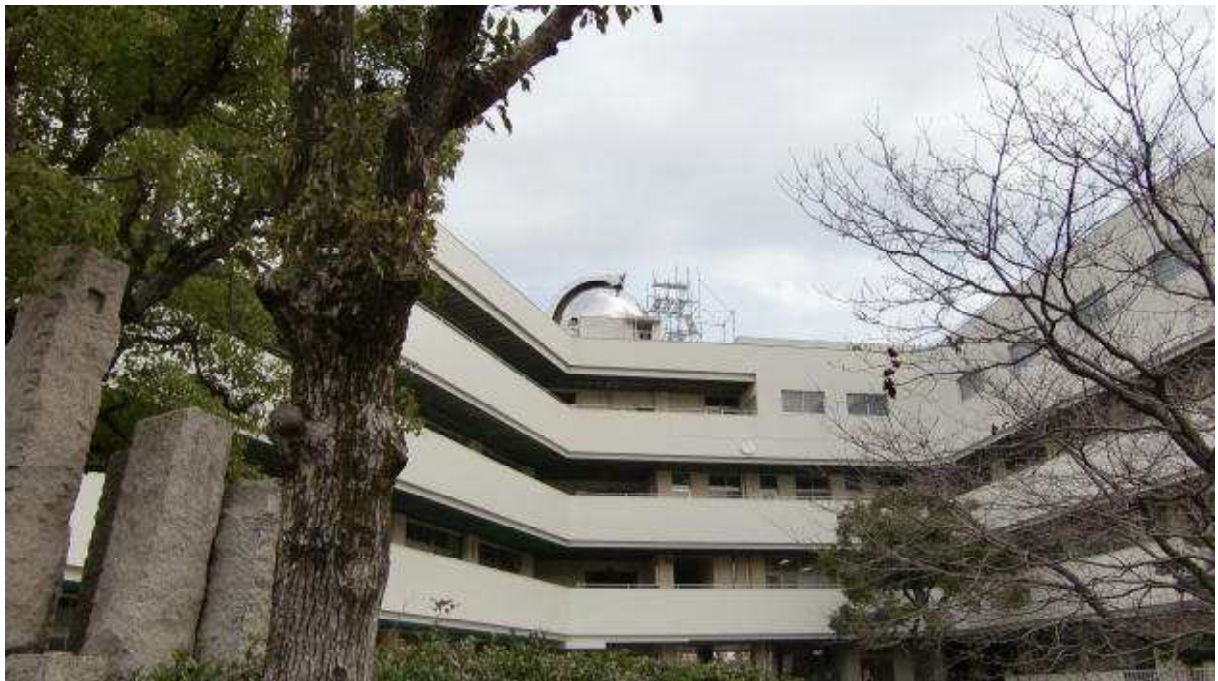
・昨年度末に、外壁の塗装工事を終え、リニューアルされた中庭からの校舎
